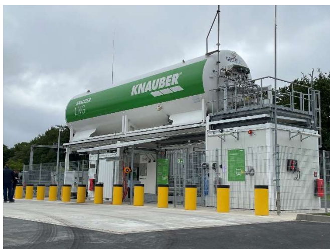
Die neue LNG-Tankstelle in Cloppenburg.
